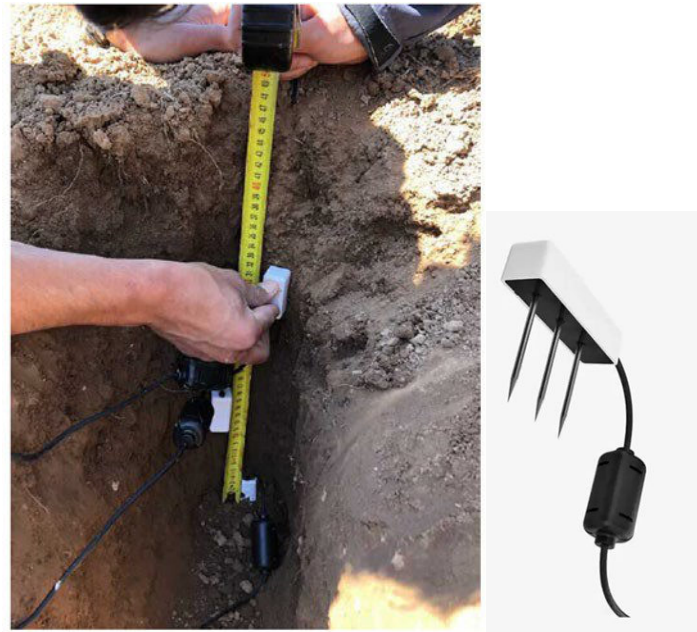
Illustration 16 : installation de capteurs d'humidité à différentes profondeurs
